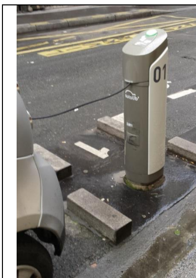
Borne de recharge électrique
