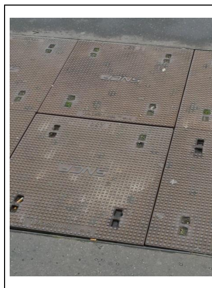
Installation électrique de gare
