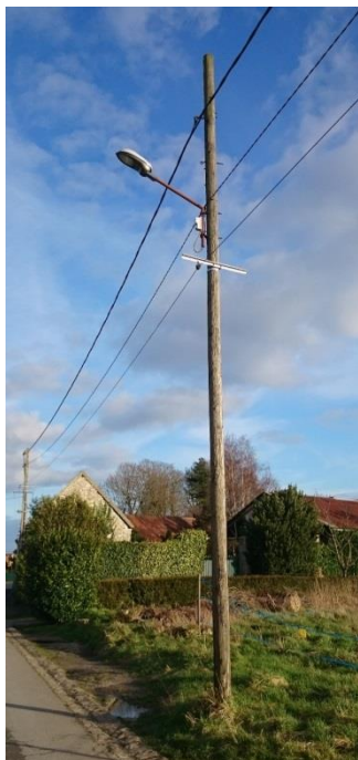
Eclairage public sur support bois commun
