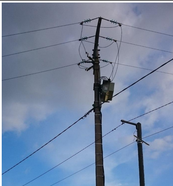
Réseau aérien BT torsadé sur support HTA
