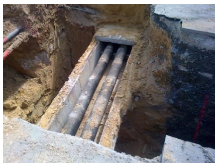
Réseau en caniveau
