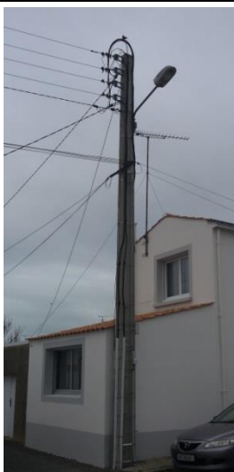
Réseau aérien BT sur support commun
