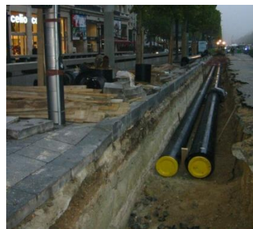
Réseau en pleine terre
